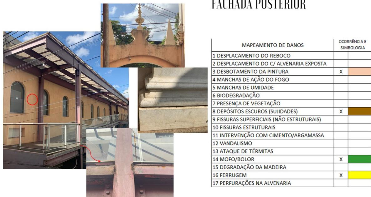
FIGURA 42 – Mapeamentos de danos Fachada Posterior
