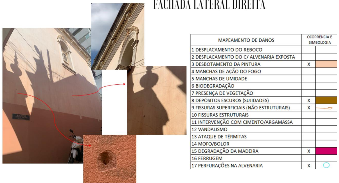
FIGURA 38 – Mapeamentos de danos Fachada Lateral Direita
